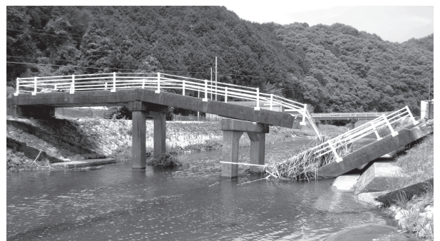
豪雨による増水で崩落した法寿院橋（有井川）
