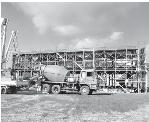
新築工事が進む あったかふれあい センターよりあい (1月12日、錦野団地)
