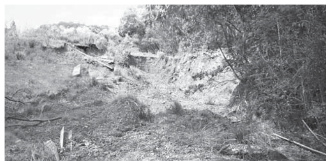
崩落した残土処理場(大井川)
