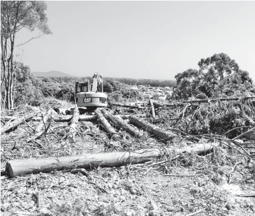
新庁舎建設にむけて立木伐採工事中です。奥側左には井の岬が
