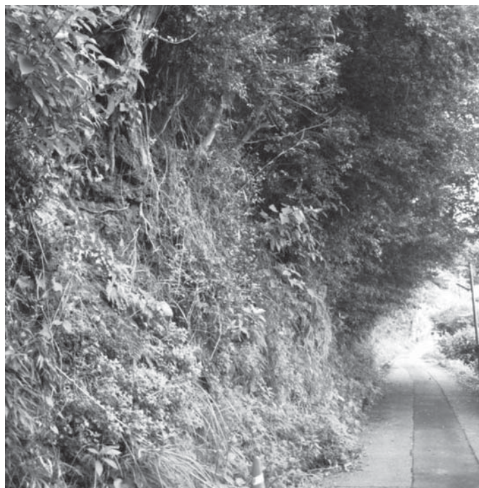
弘野への町道の危険個所
